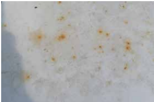
Korrosionsschäden wegen zu geringer Schichtdicke
