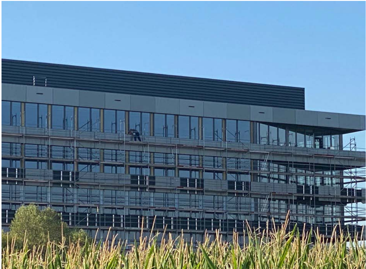
Abbildung 3: Farbtonabweichung an einer Fassade
